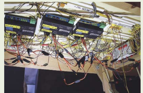
Foto 14: Onder de linker module zijn de andere 4 SwitchPilots aangebracht, waarna Y kabels de verdeling naar de servo's voor hun rekening nemen. Tegen de balk ligt de pendelautomaat van Viessmann. Tevens ziet u dat alles gelabeld is, om een eventuele storing snel op te kunnen sporen.
